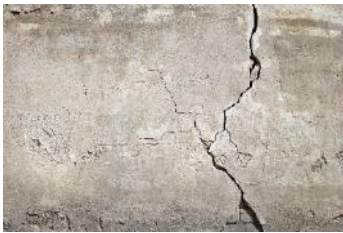
Chapes fissurées et/ou granuleuses
